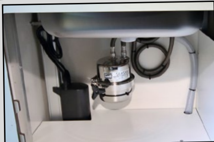
Histoire que l'eau sortant du robinet soit potable, un système de filtre Seagull IV pose ses valises sur l'arrivée d'eau de l'évier.
